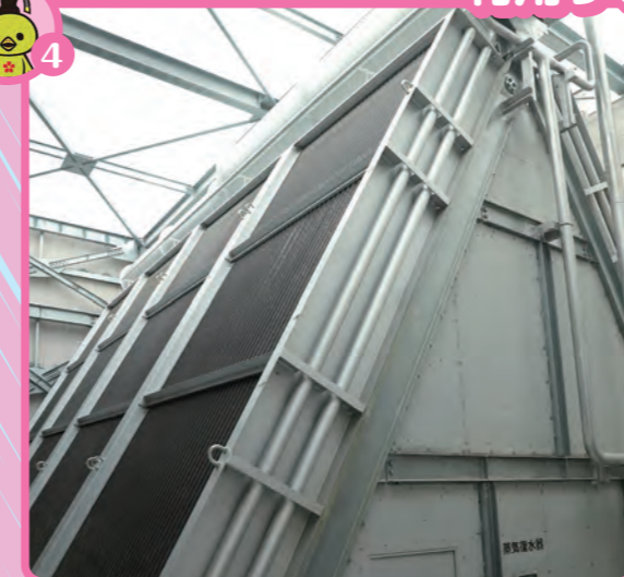
7 蒸気復水器 タービンで発電に利用した蒸気を水に戻します。戻した水はボイラに送られ、再び蒸気になります。
