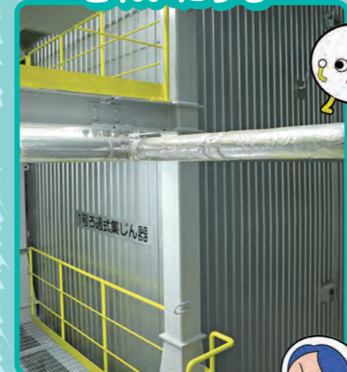
8 ろ過式集じん器 排ガスの中の細かい灰をとり、薬剤と反応させて、排ガスをきれいにします。
